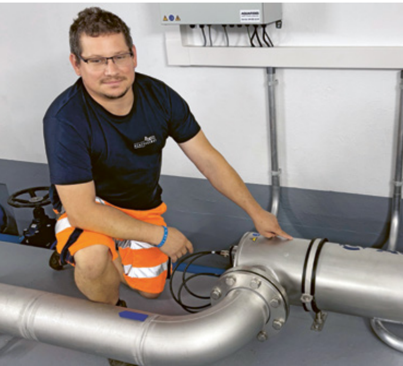
Patrick Frei zeigt die seit rund einem Jahr installierte UV-Bestrahlungsanlage im Grundwasserpumpwerk Rüteli 2 beim Altersheim. Sie bietet einen zusätzlichen Schutz gegen bakterielle Verunreinigung. (Foto: cu)
