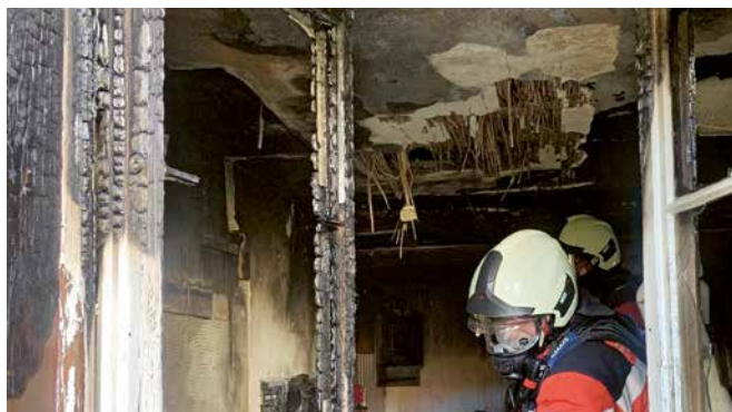
Unter Atemschutz kontrollierten die Einsatzkräfte das stark beschädigte Erdgeschoss und löschten die letzten Glutnester im Gebäudeinnern.
